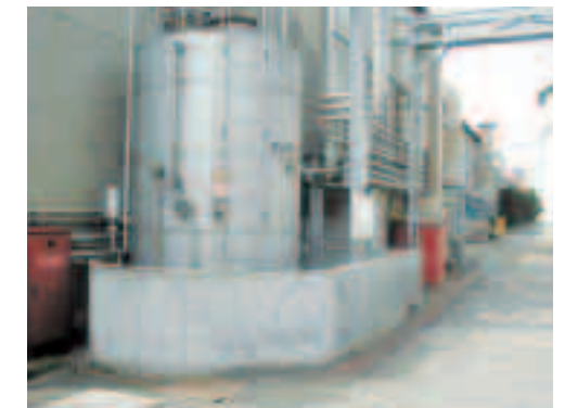
屋外薬品タンクの防油堤
