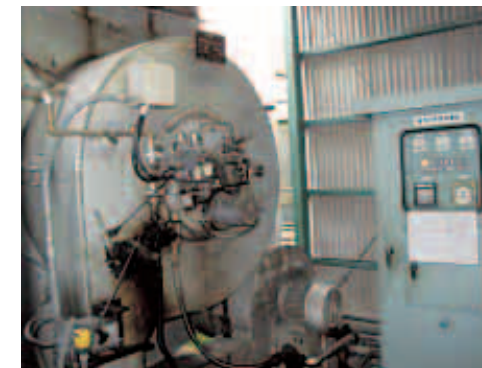
直熱式脱臭装置
