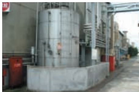
ジクロロメタン貯蔵タンクの防液堤
