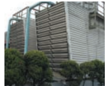
冷却水循環装置
