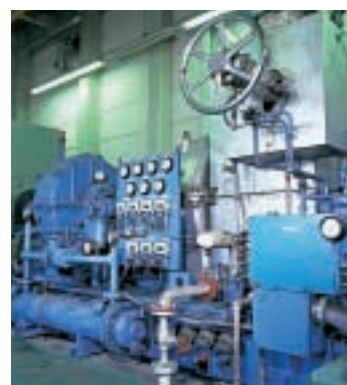
仙台工場のコジェネレーション用タービン
