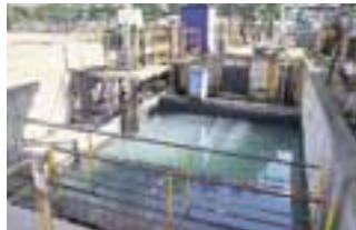
排水処理装置
