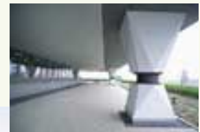
テラスガーデンの免震支承(上)とセンター外観(左)
