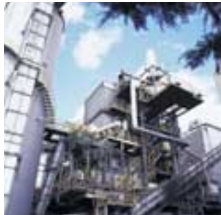
排煙脱硫装置を設置したコジェネレーションボイラー
