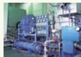
仙台工場のコジェネレーション用タービン
