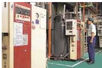
天然ガスボイラー
