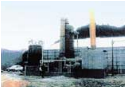
鶏糞発酵室から発生する悪臭の除去装置
