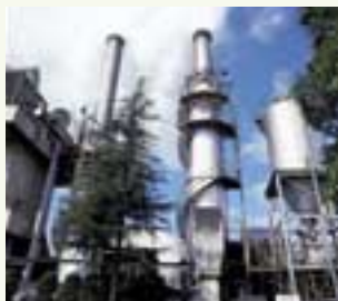
仙台工場のコジェネレーション装置
