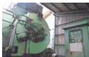
省エネに貢献するボイラー(直熱式脱臭装置を兼ねる)
