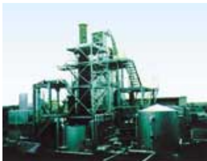
廃棄物焼却設備の焼却炉排ガス処理装置
